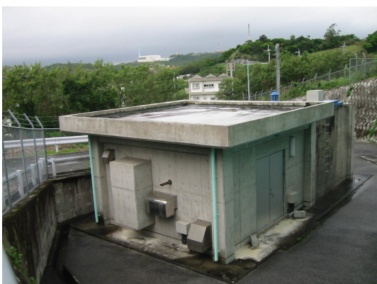
与那原ポンプ室（与那原第一配水池施設内）
