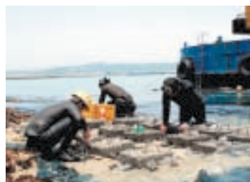
新設された「ヒジキ礁」
