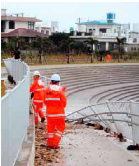
暴風と波の力で折れ曲がったフェンス
