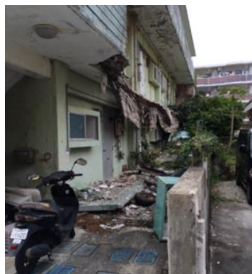
塩害被害等による共用廊下崩落 築35年のアパート（浦添市）
