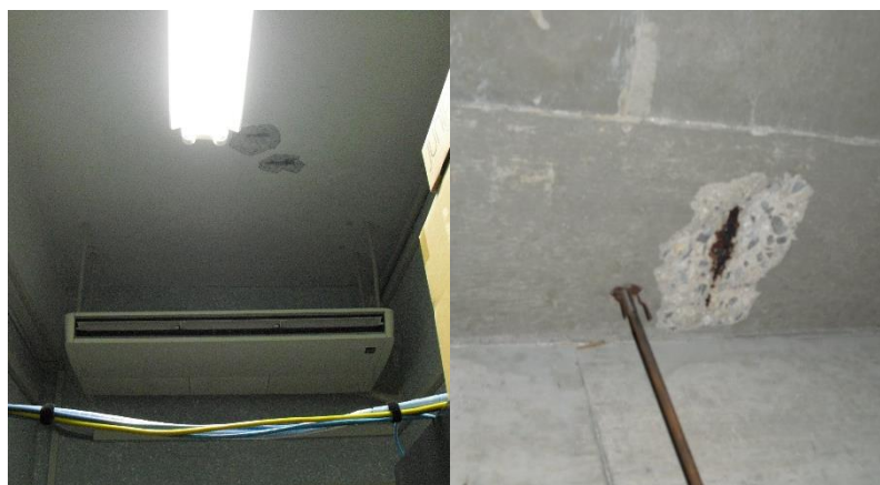
本庁舎におけるコンクリートの爆裂 (左：サーバー室 右：天井内)
