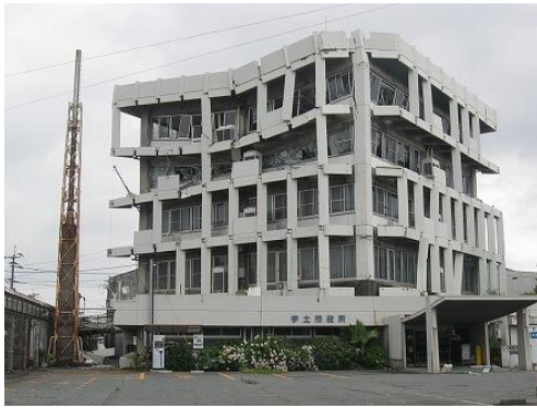
半壊した宇土市庁舎
