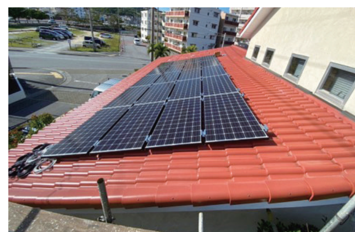
太陽光パネル
