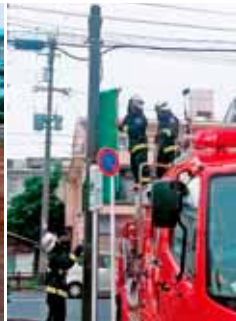
壊れかけた看板を応急処置する東部消防本部職員
