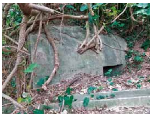
ひび割れなど老朽化が進むトーチカ （板良敷戦争遺跡）
