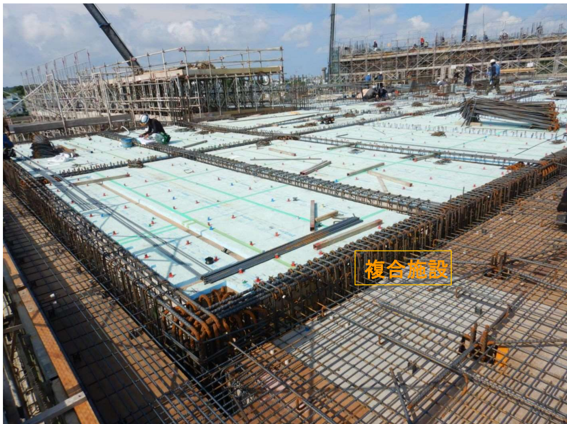
②複合施設 2階梁配筋状況。R階枠・断熱材打ち込み完了。
