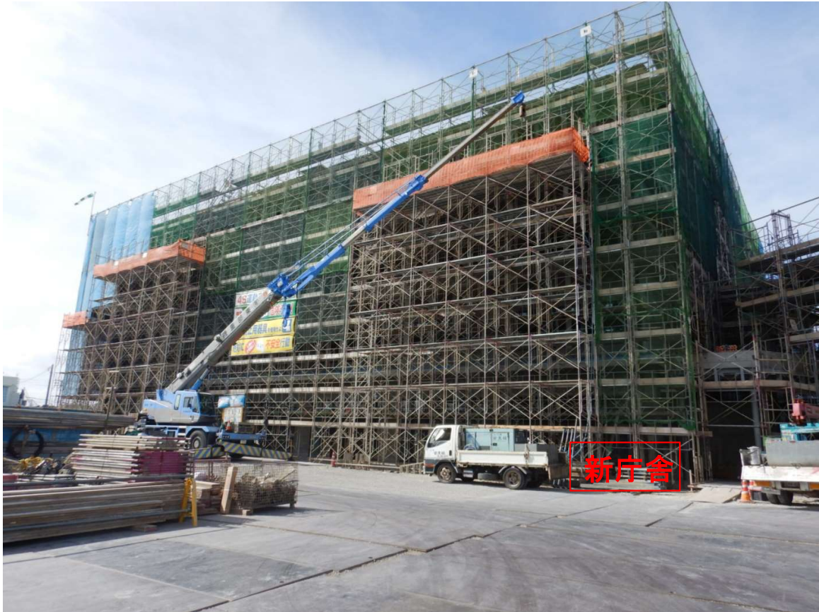
①新庁舎 外部左官補修。2F赤瓦マスブロック準備工。
