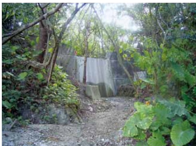
土砂が堆積し、機能していない治山ダム
