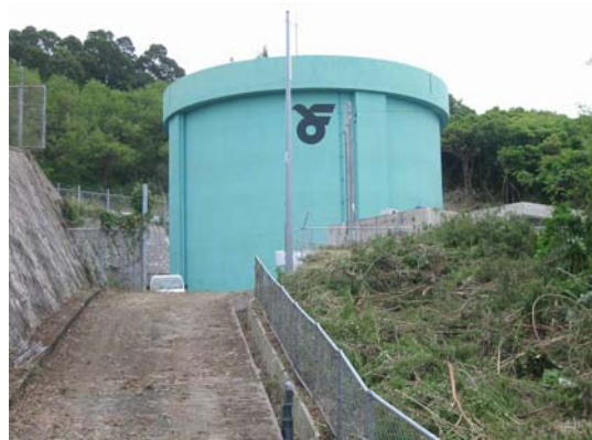
与那原第一配水池（大見武区）
